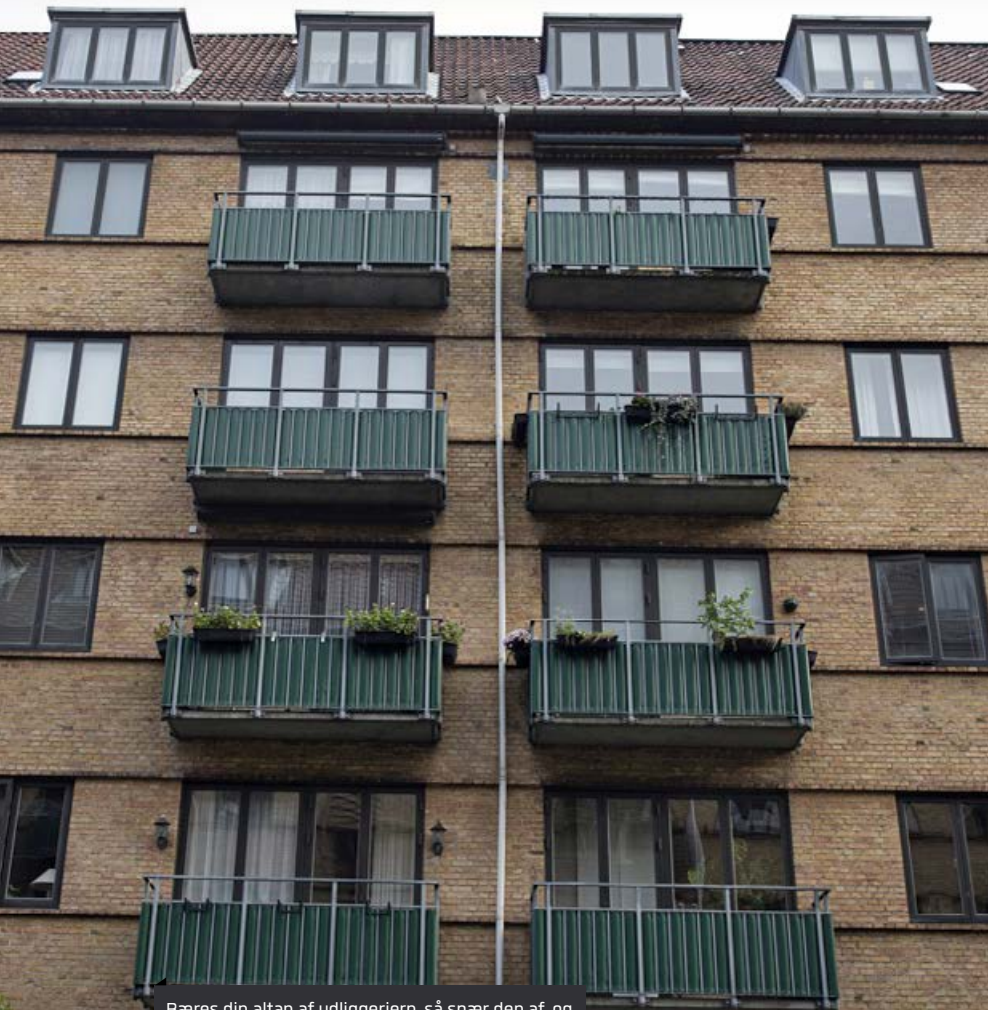
Bæres din altan af udliggerjern, så spær den af, og få den undersøgt. (Altaner på foto er ikke i fare)
