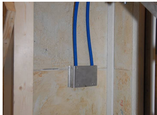
16. Beskyttelse af koblingsdåser på væggenes bagside.
