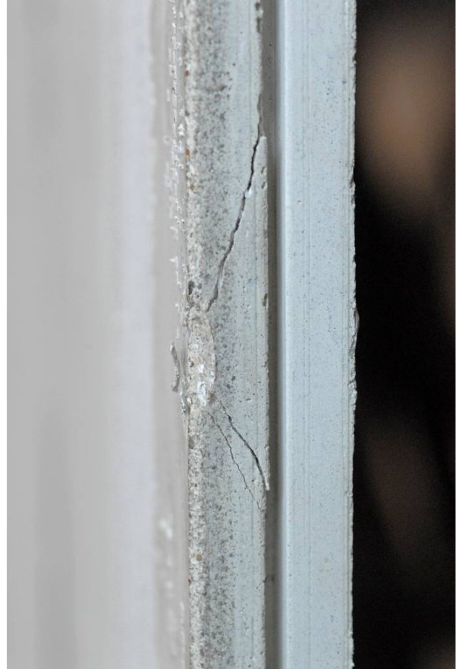
30. Skade på pladekant (not) efter dynamisk last med stålkugle.
