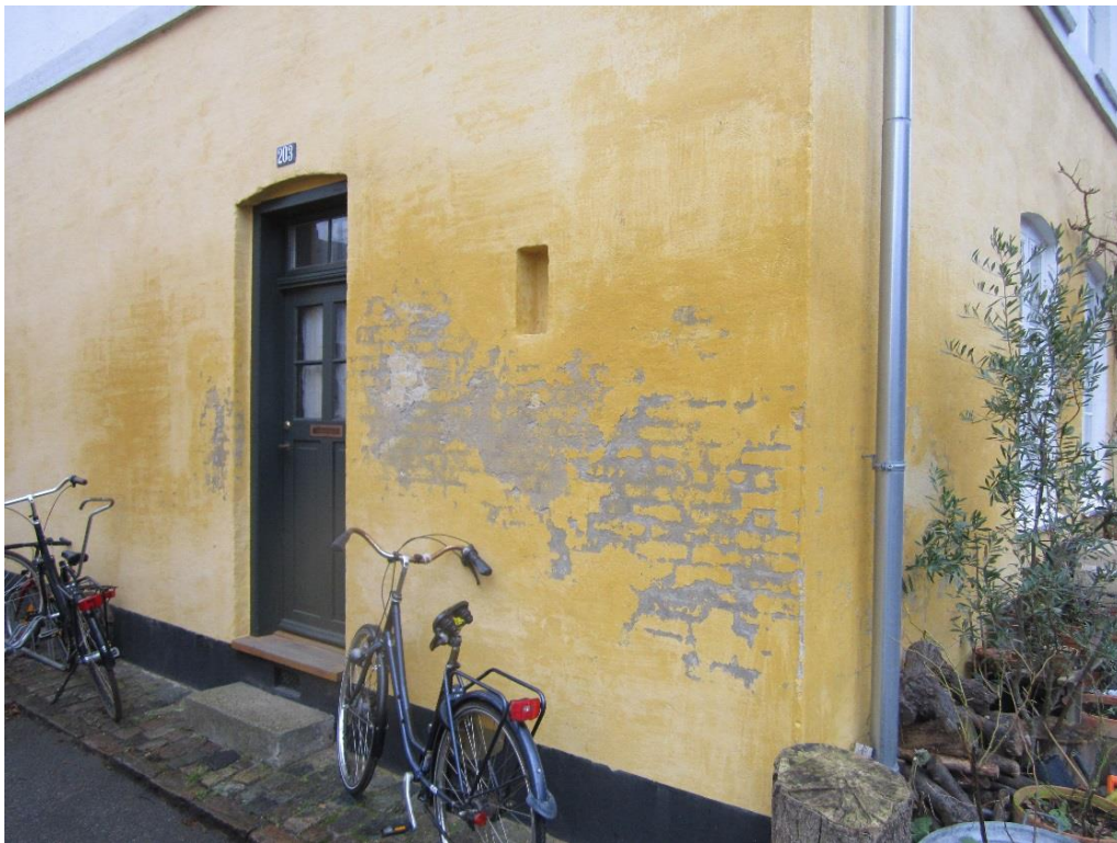
Foto 11. Saltskader på gavl, Brumleby, Østerbro
