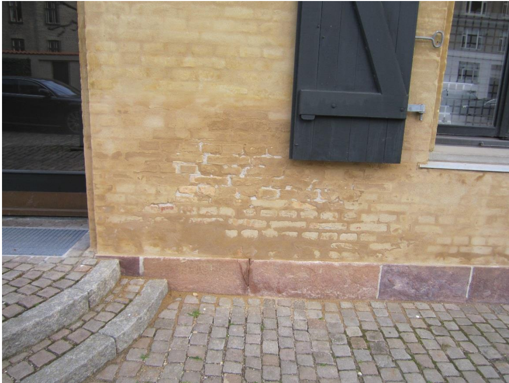
Foto 14. Tøsaltning eller opstigende grundfugt? Gule Pakhus, Toldbodgade 38
