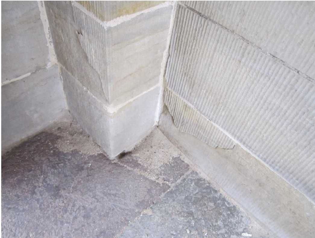
Foto 9. Saltskader på sandsten, Rigsdagsgården, Slotsholmen,
