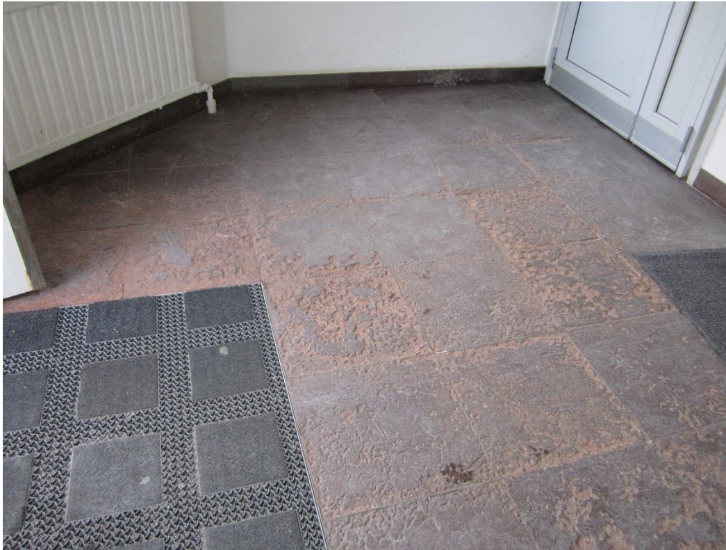
Foto 16. Gulyfliser af Ølands kalksten nedbrudt af tø-salt? Gentofte Sygehus
