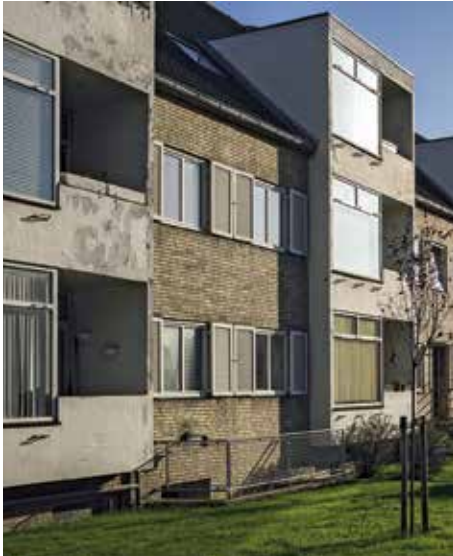
Ibstrupparken, Gentofte. Nedbrydning af de støbte karnapper, på grund af korrosion i jern. Udstøbningen omkring jernet er for tynd, og vandet finder ind til jernet gennem mikroskopiske revner og forårsager rust.
