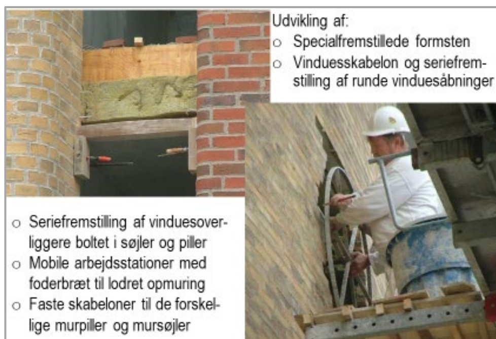
FIGUR 32. Eksempler på udvikling af materialer, metoder, værktøjer og materiel i murerentreprisen på Bispebjerg Bakke, 2400 København NV ledet af murerformand Kim Cordsen.
