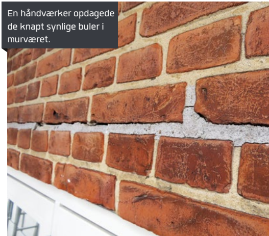
Her ses de korroderede overliggere
