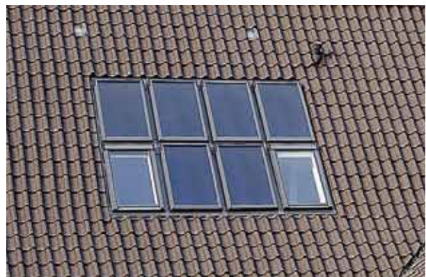
Et vindues parti kan kombineres med solceller. Her er to vinduer og seks solcelleplader.
