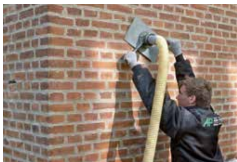
Indblæsning af hulmursisolering, der foregår ved at udtage sten i ydervæggen med 1½-2 meters mellemrum og lukke hullerne med de samme sten, som er blevet udtaget.
