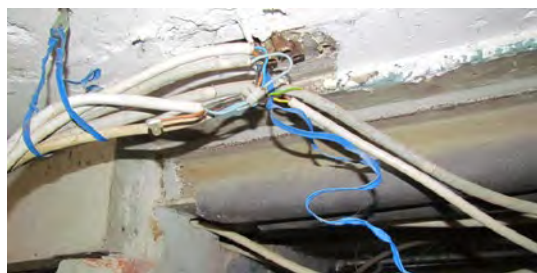
Ulovlig elinstallation i kælder. Kabler skal være ophængt på forsvarlig vis og ledningerne skal være samlet i en dåse.
