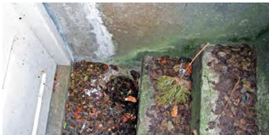
Riste skal renses, så afløb og kloak ikke tilstoppes, som vist på billedet.
