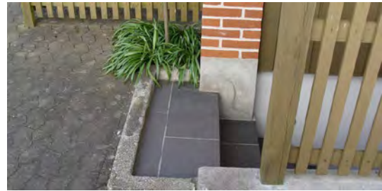
Eksempel på støbt opkant til kælderskakten. Kanten forhindrer, at der løber vand ned i kælderen, før vandstanden når en vis højde.
