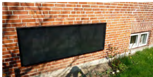
Soldrevet ventilation der ventilerer kælderen med opvarmet luft. Løsningen medvirker til at affugte kælderen.
