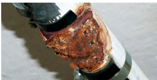
Nedslidt rør, der er forsøgt repareret. Røret udgør en risiko for oversvømmelse, når det går helt i stykker.
