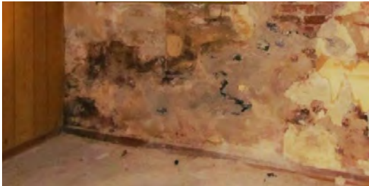
Tegn på opfugtning i kældervæg.
